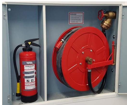
Abbildung 1: Beispiel für Wandhydrant mit zusätzlichem Feuerlöscher
