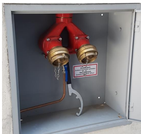
Abbildung 6: Beispiel für Löschwasser-Einspeiseeinrichtung
